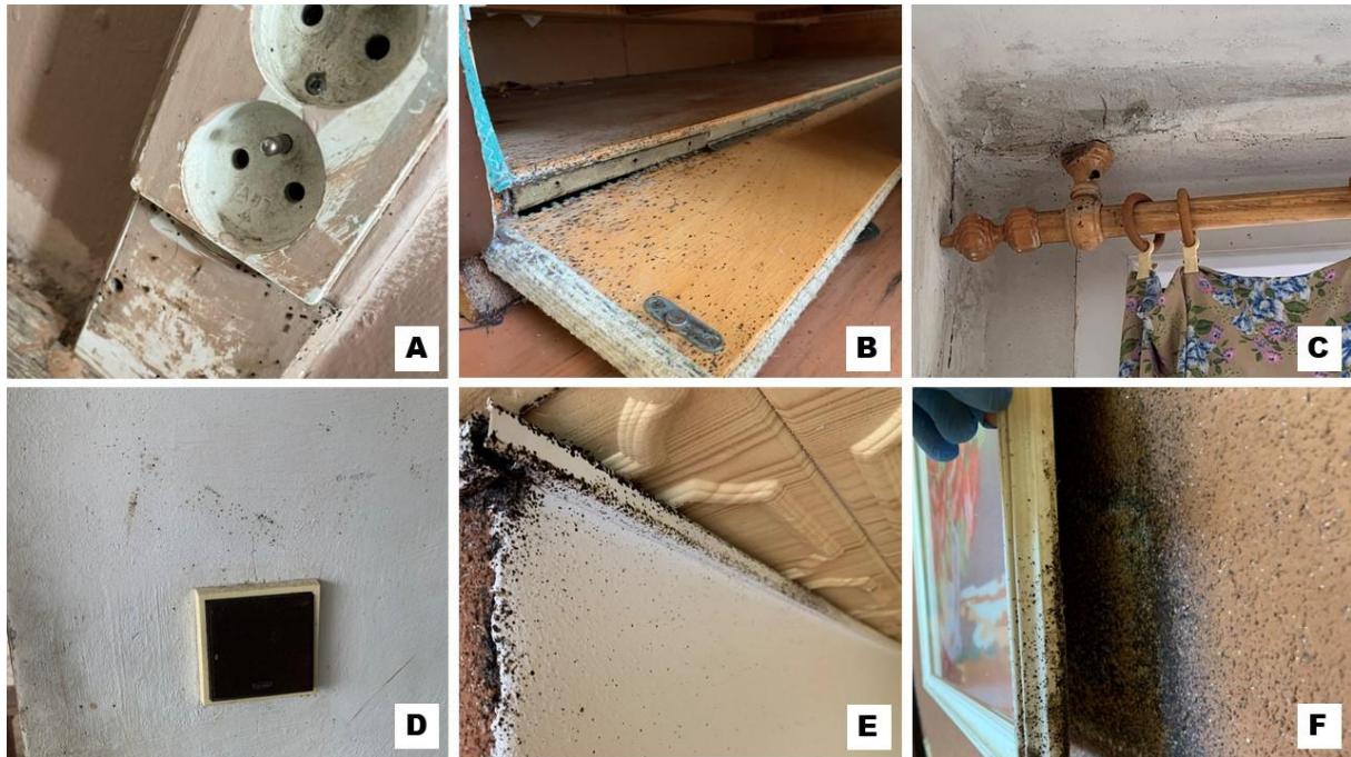
Obrázek č. 8: (A) trus v okolí zásuvek, (B) trus na dřevěné konstrukci nábytku, (C) trus na zdi v okolí oken, (D) trus v okolí vypínače, (E) trus na stropní liště, (F) trus na zdi v okolí obrazu
